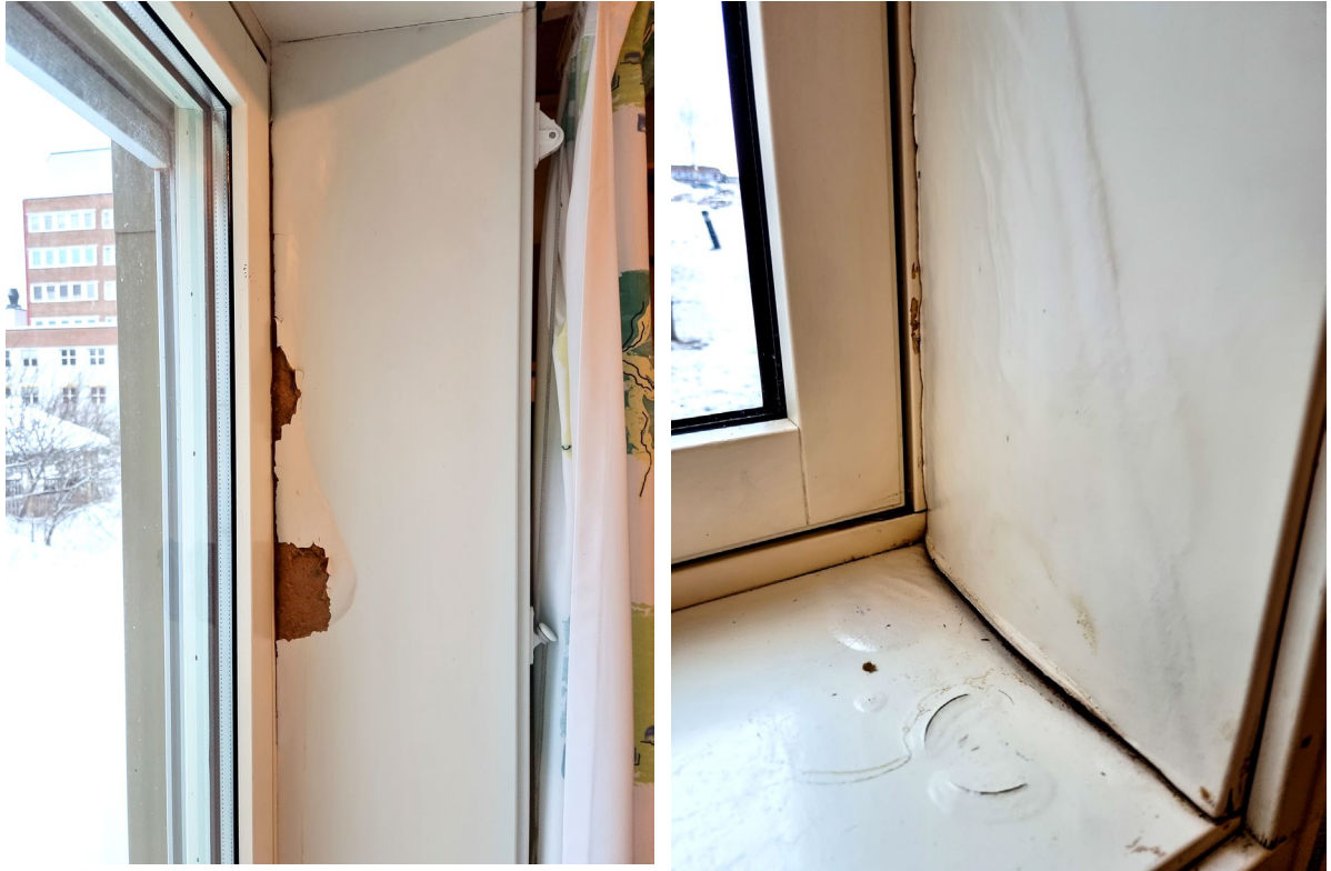
Vannskader rundt vindu plan 1 Fløy 1981
