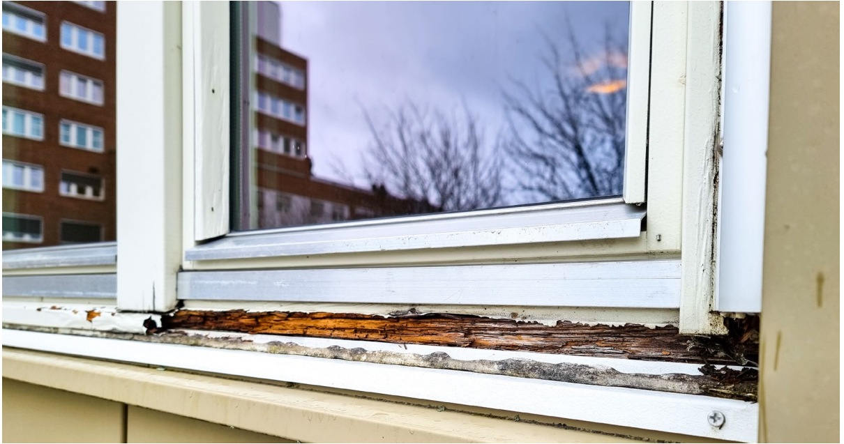
Skadet vindu fløy B 1981.
