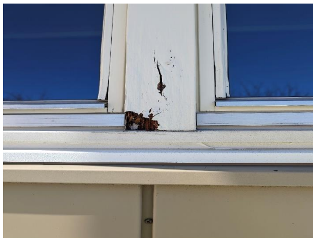
Figur 15 Vindusposter har råteskader
