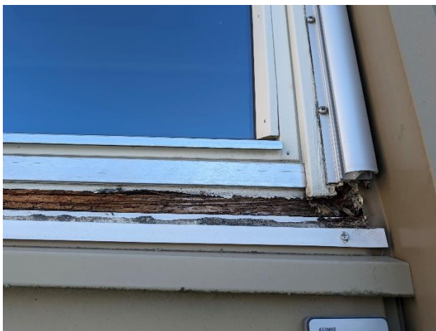
Figur 14 Tydelige råteskader på vindu.
