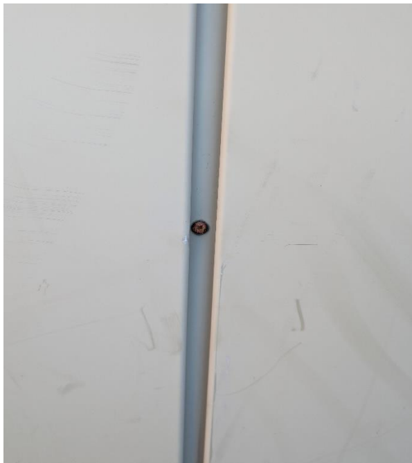
Figur 12 Skruer på fasade tekniskrom er startet å ruste.
