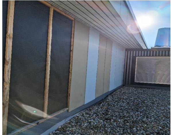
Figur 11 Fasade tekniskrom på tak. Mangler plater etter en storm.
