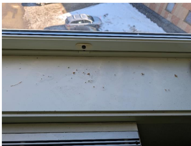
Figur 17 Vindusforinger har svellet ut.
