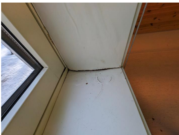
Figur 16 Tydelige tegn på fukt. Vindusforing har svellet.
