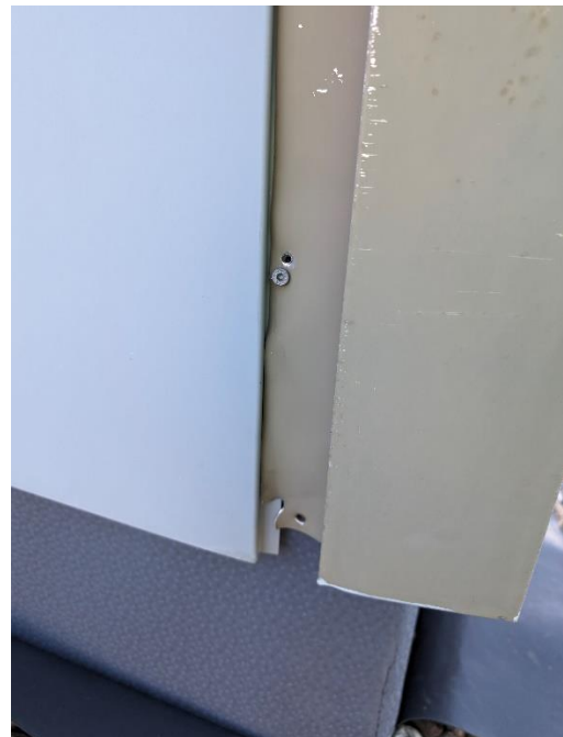
Figur 13 Fasadeplater er midlertidig festet etter at skruer har rustet.
