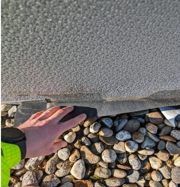
Figur 24 Uvisst hva som er gjort her. Mulig vannsamling bak sarnafil.
