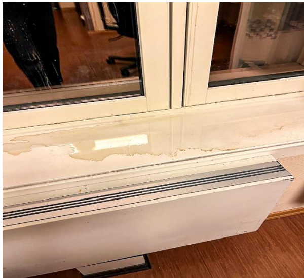
Figur 18 Vann i vindusforinger. Bildet er tatt av HSYK.
