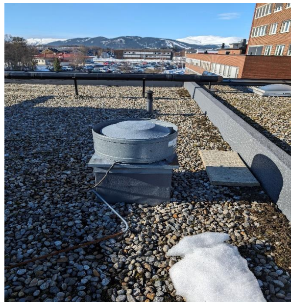
Figur 23 Tekniske installasjoner på tak. Uvisst om de fortsatt er i bruk.
