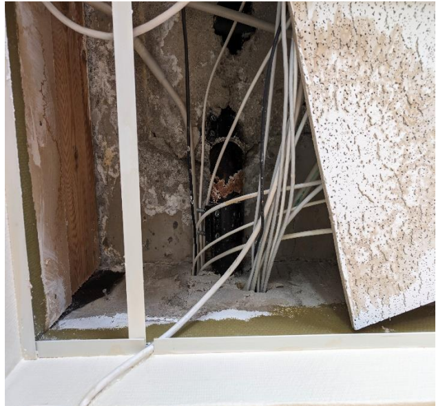
Figur 27 Fuktutslag i kjelleren.
